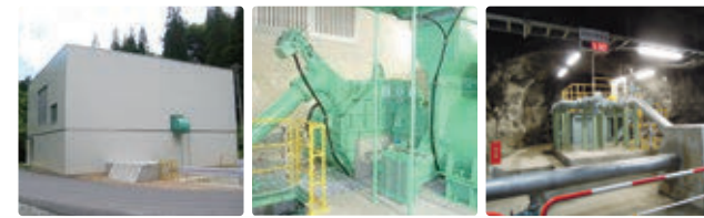
和佐保発電所外観 和佐保発電所タービン 天狗の団扇発電所
